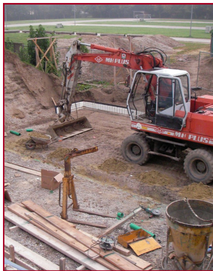
Im Jahr 2007 wurde mit dem Bau des Bürgerhauses begonnen, der Einzug erfolgte 2008
